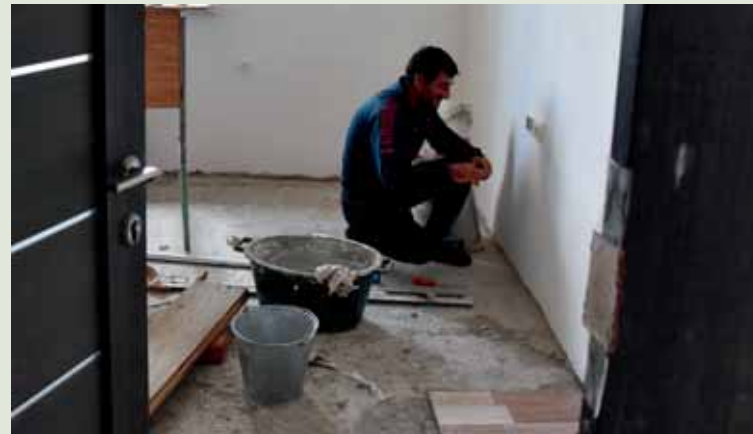
Սալուսի վարչական շենքը տասնամյակներ անց առաջին անգամ է վերանորոգվում: Նույն շենքում է գտնվում նաև բնակավայրի դպրոցը:
