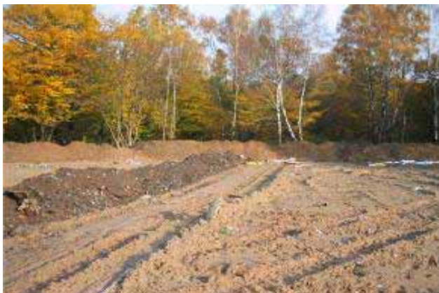
Լուսանկար 15. Արտաքին մեկուսիչ լիրաթմբի և թափոնների տեղադրման հատվածի ներքին (կենտրոնական) մեկուսիչ լիրաթումբը
